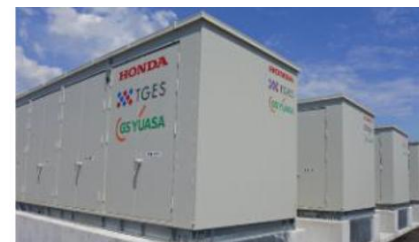
【日本における大規模BESS導入事例】
